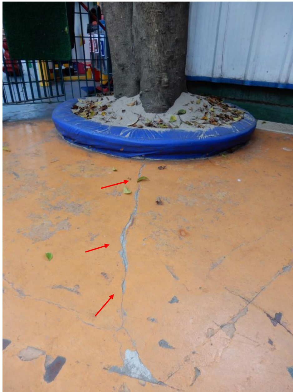
Figura 11 – Piso danificado pelo exemplar nº 216; detalhe de rachadura no piso.
