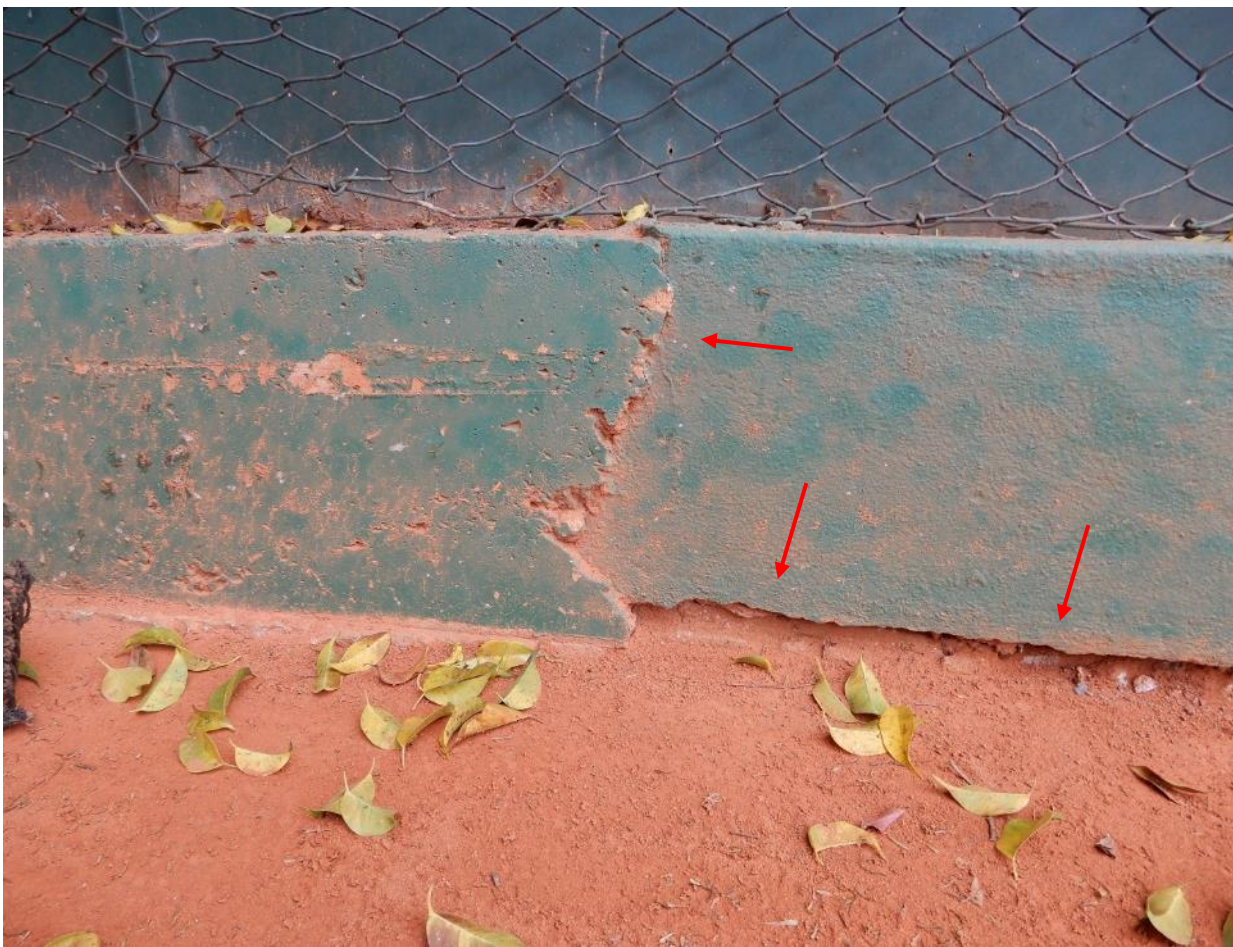
Figura 23 – Detalhe de rachaduras existentes na base do alambrado que faz limite com a quadra de tênis.
