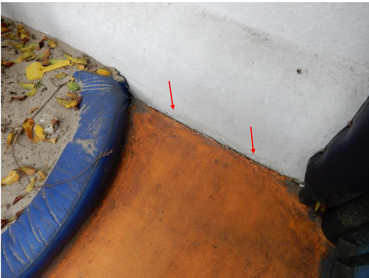
Figura 14 – Junção do piso com o muro danificada pelo exemplar nº 217.
