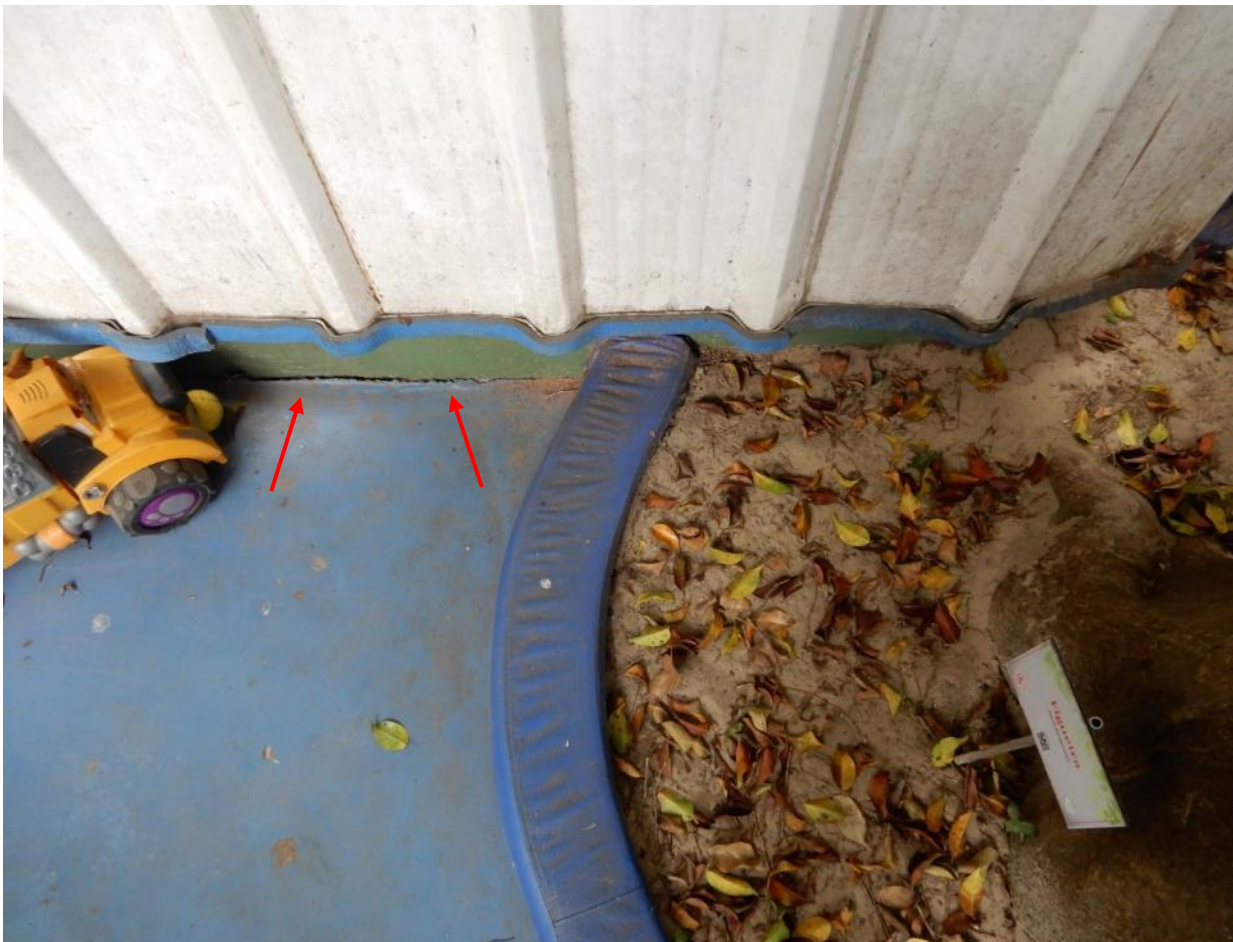
Figura 17 – Junção do piso com o muro danificada pelo exemplar nº 218.
