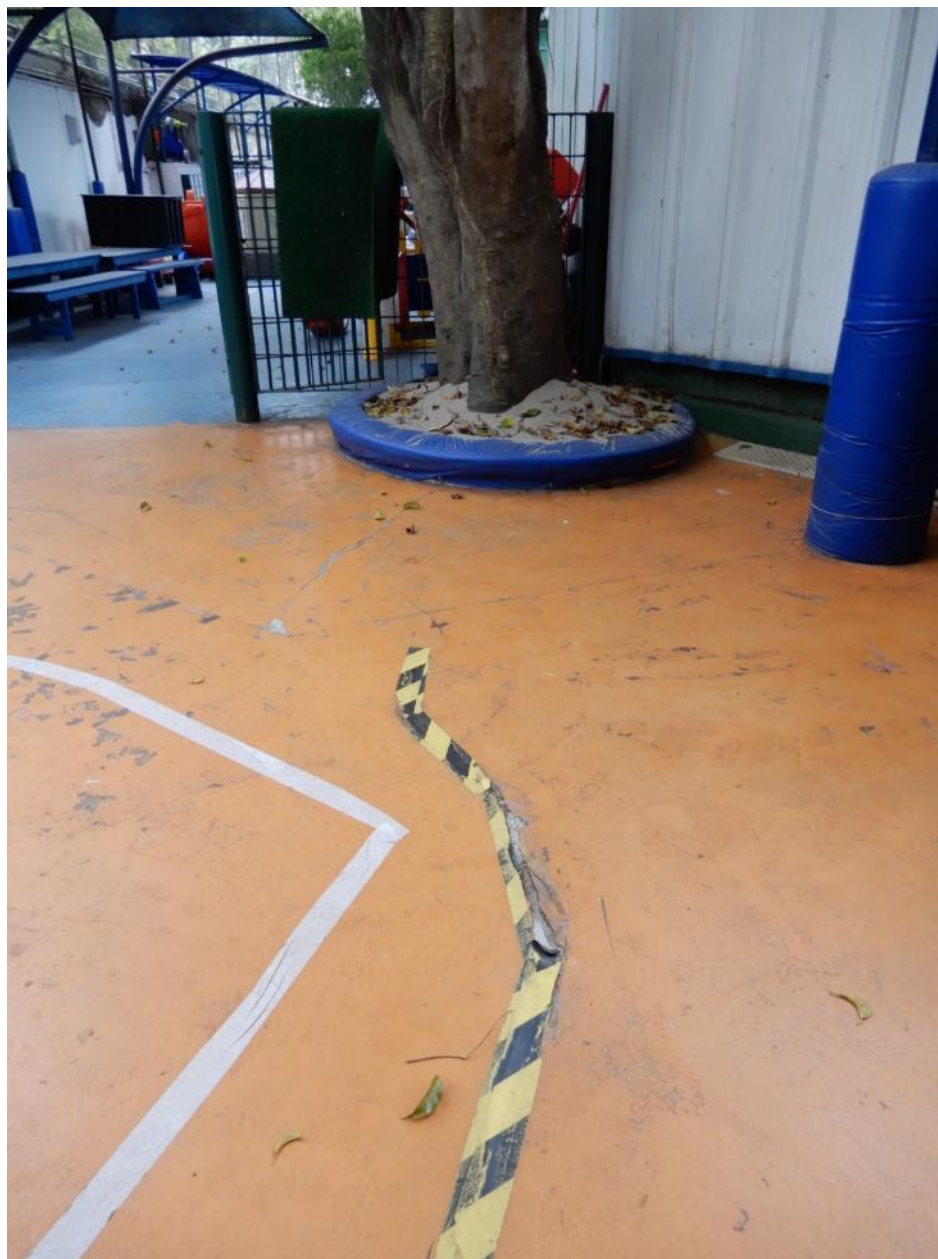
Figura 10 – Piso danificado pelo exemplar nº 216; detalhe do “degrau” formado e da sinalização improvisada para evitar acidentes.
