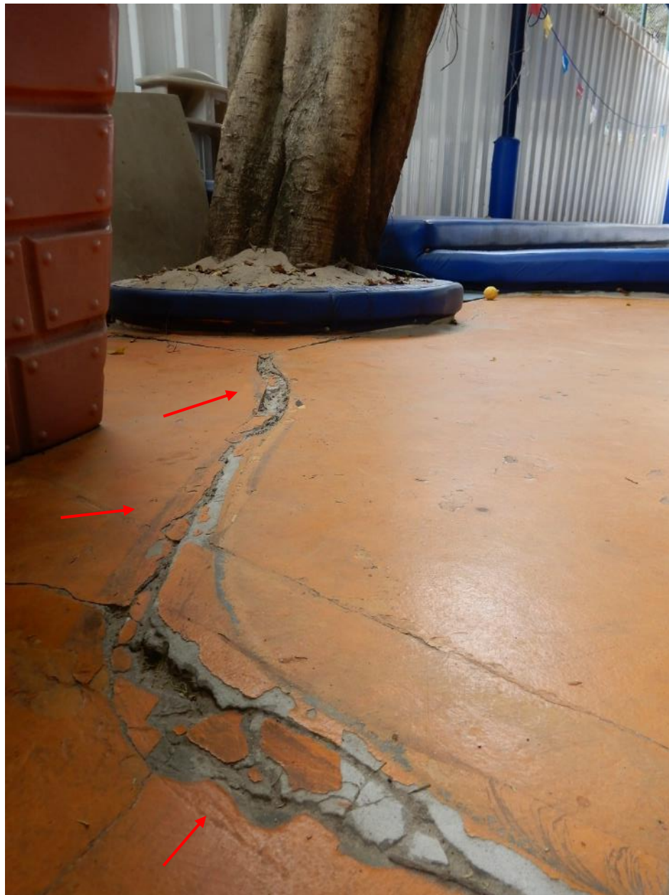
Figura 4 – Piso danificado pelos exemplares nº 213 e 214; detalhe do “degrau” formado
