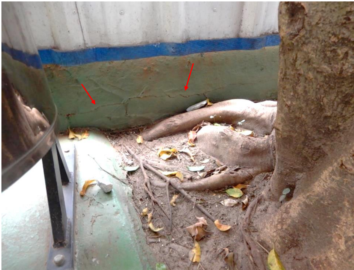
Figura 21 – Raízes do exemplar nº 221 danificando o muro que separa a escola da quadra de tênis.
