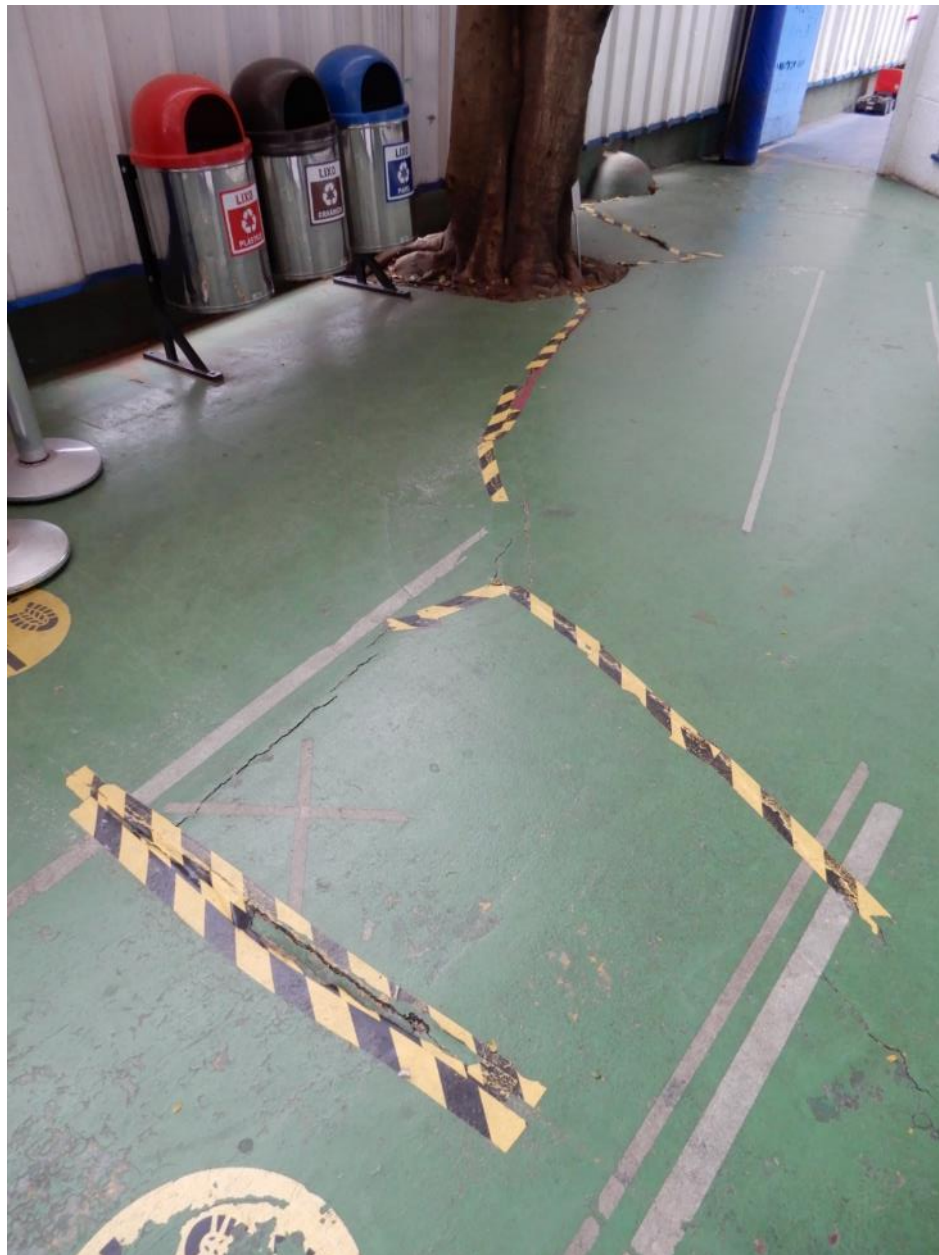
Figura 19 – Piso danificado pelo exemplar nº 221; sinalização improvisada para evitar acidentes.
