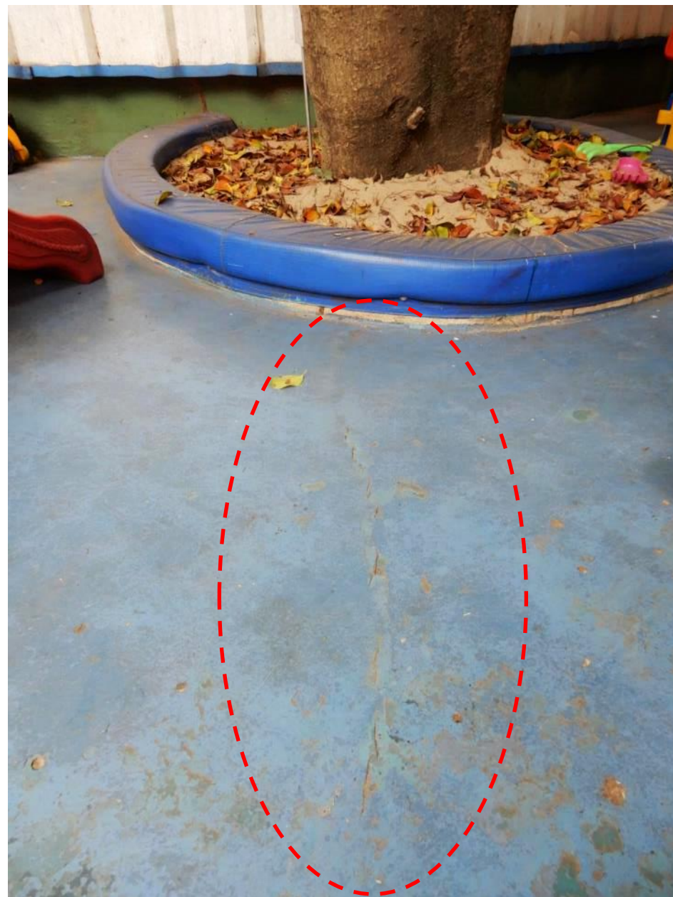
Figura 16 – Piso danificado pelo exemplar nº 218.
