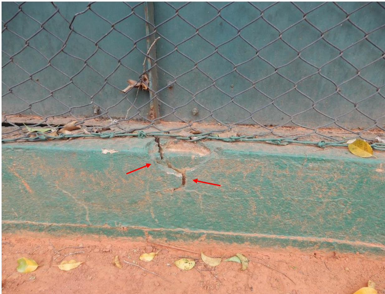
Figura 24 – Raízes do exemplar nº 221 danificando o muro que separa a escola da quadra de tênis.
