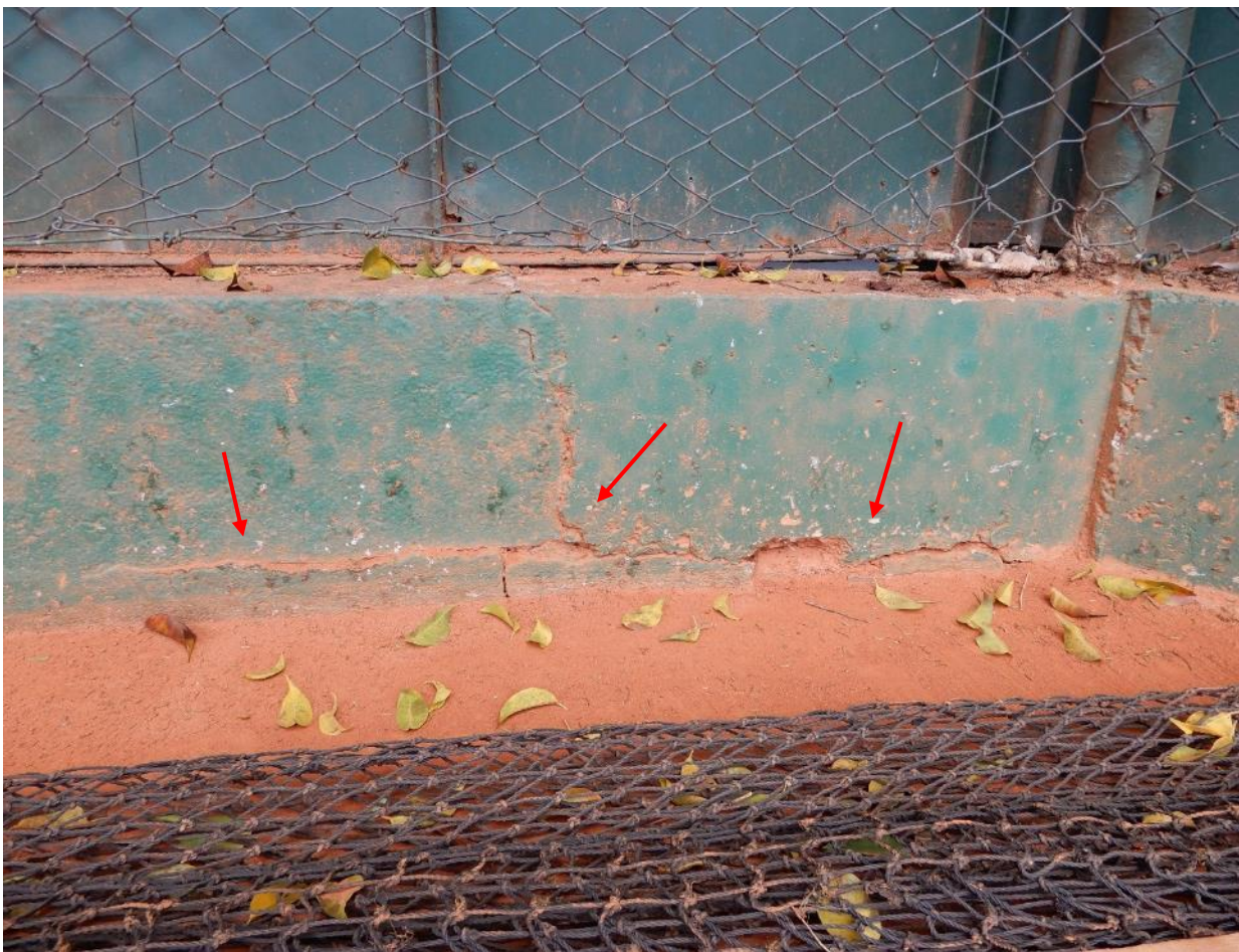
Figura 22 – Detalhe de rachaduras existentes na base do alambrado que faz limite com a quadra de tênis.
