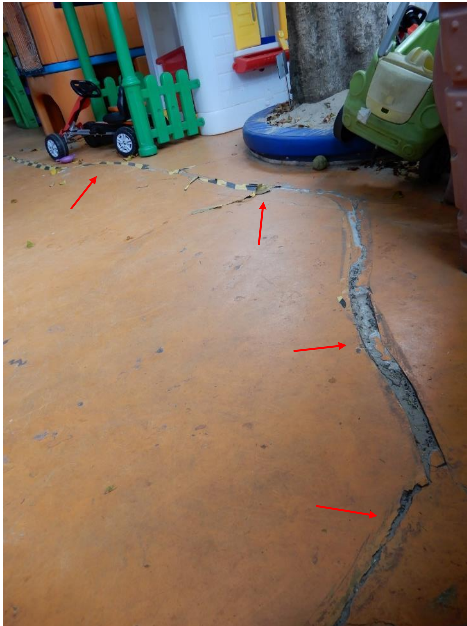
Figura 5 – Piso danificado pelos exemplares nº 213 e 214; sinalização improvisada para evitar acidentes
