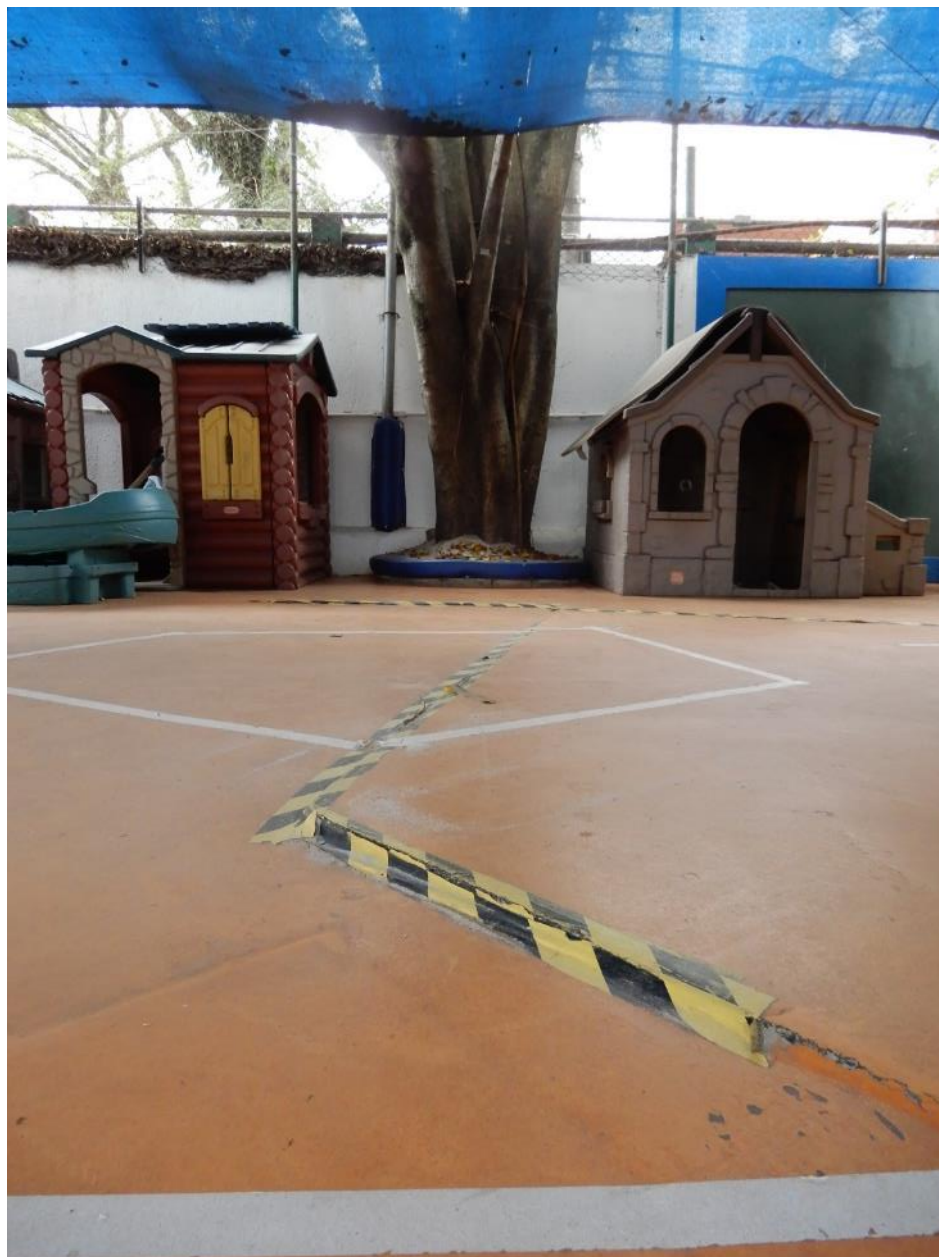
Figura 7 – Piso danificado pelo exemplar nº 215; detalhe do “degrau” formado e da sinalização improvisada para evitar acidentes.
