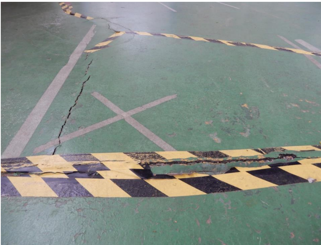
Figura 20 – Piso danificado pelo exemplar nº 221; detalhe do “degrau” formado e para a sinalização improvisada para evitar acidentes.
