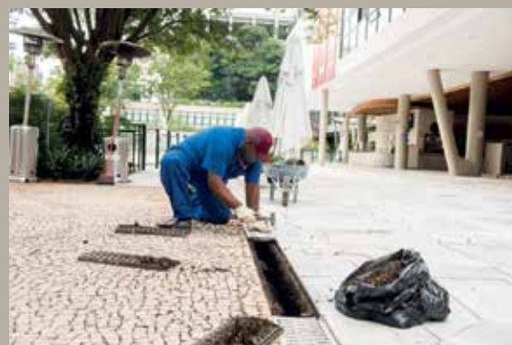
Manutenção de ralos ao lado do Expresso
