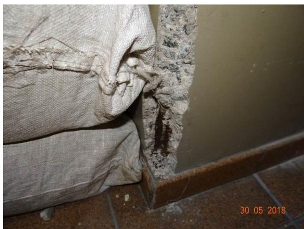
FOTO 7 – Disgregação do concreto e armadura corroída na face Sul do pilar P44.
