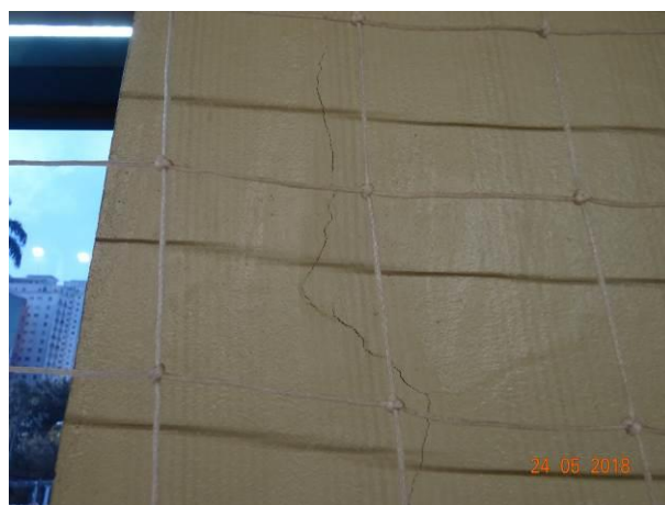
FOTO 20 – Disgregação do concreto na face Oeste do pilar P76.
