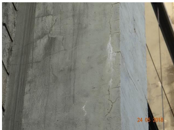
FOTO 41 – Fissuras longitudinais na face Norte do pilar P71. Nota-se a presença de eflorescência.
