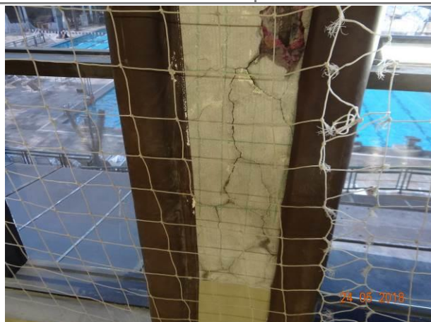
FOTO 21 – Armadura corroída na face Oeste do pilar P77.
