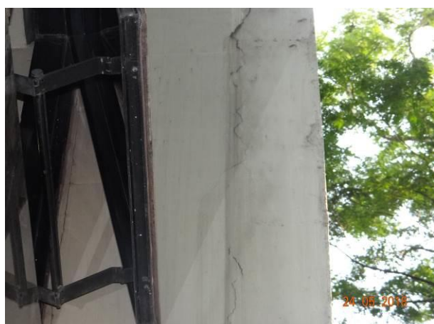
FOTO 37 – Fissura longitudinal indicando provável corrosão da armadura na face Leste do pilar P21.
