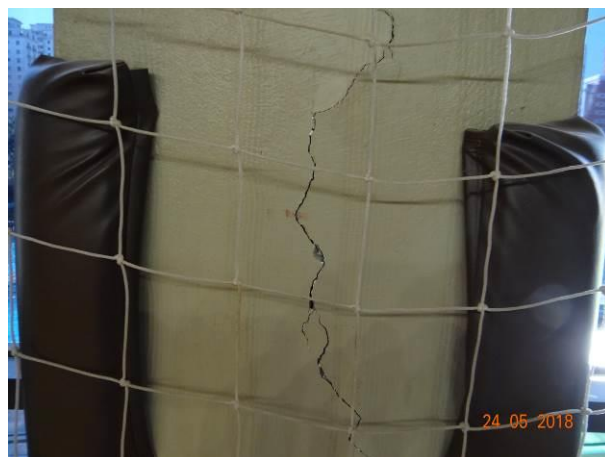
FOTO 18 – Detalhe da anomalia referenciada na foto anterior.
