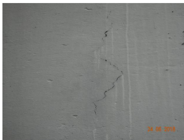
FOTO 36 – Detalhe da anomalia referenciada na foto anterior.
