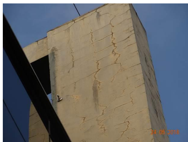
FOTO 44 – Fissuras aleatórias na face Norte do pilar P66.
