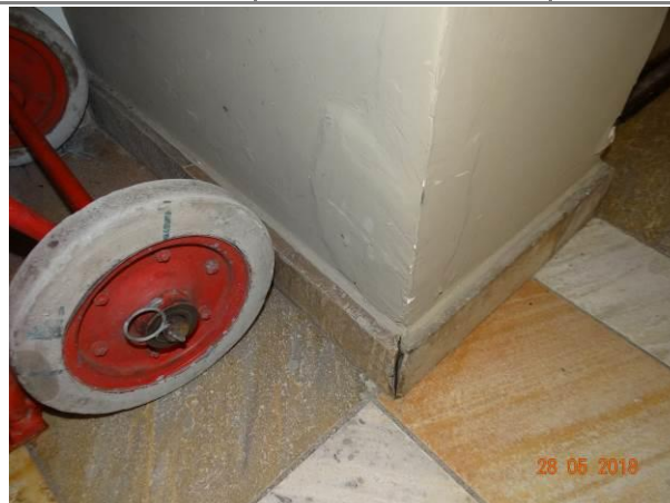
FOTO 10 – Disgregação do concreto em decorrência de corrosão da armadura embutida na face Norte do pilar P74.
