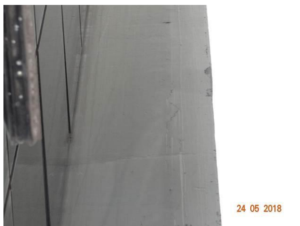
FOTO 35 – Fissura longitudinal indicando provável corrosão da armadura na face Leste do pilar P19.
