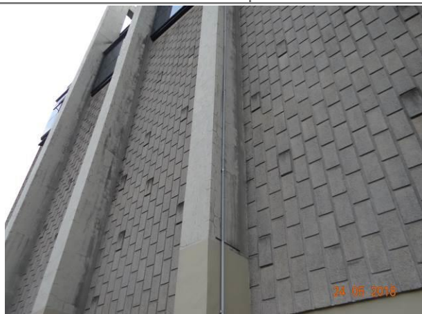
FOTO 33 – Fissuras aleatórias na face Sul do pilar P2.
