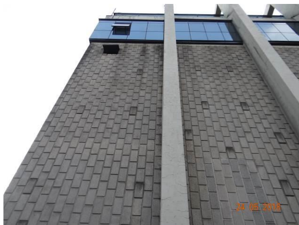
FOTO 27 – Fissuras aleatórias na face Sul do pilar P13.
