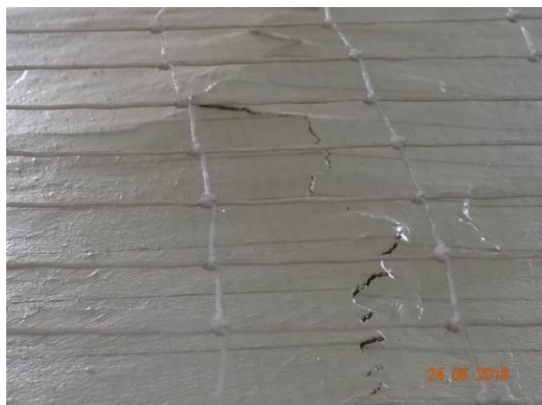
FOTO 23 – Detalhe da anomalia referenciada na foto anterior.
