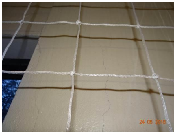
FOTO 26 – Disgregação do concreto indicando a corrosão da armadura embutida na face Oeste do pilar P80.
