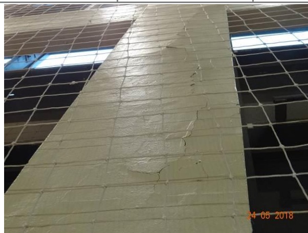
FOTO 22 – Disgregação do concreto indicando a corrosão da armadura embutida na face Oeste do pilar P78.
