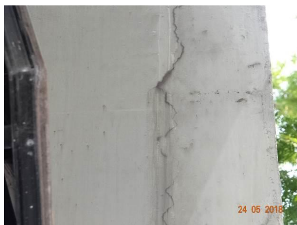
FOTO 38 – Detalhe da anomalia referenciada na foto anterior.
