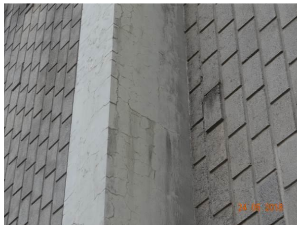
FOTO 30 – Fissuras aleatórias na face Leste do pilar P13.
