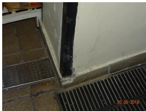
FOTO 6 – Disgregação do concreto na face Sul do pilar P42.
