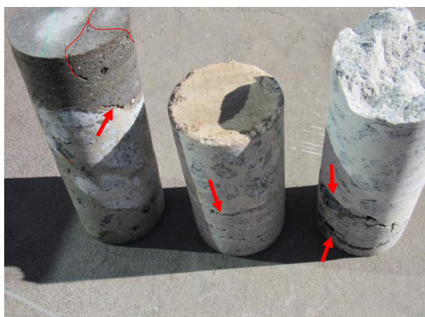
FOTO 49 – Detalhe dos testemunhos extraídos dos pilares P10 e P74. Notam-se vazios e fissuras com profundidade da ordem de 0,5 a 1,0 cm no graute.
