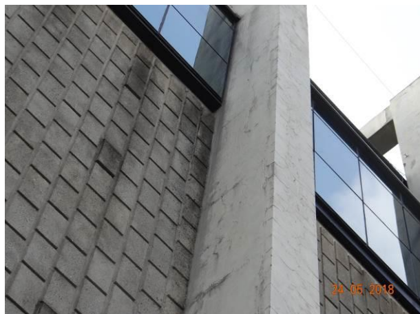
FOTO 29 – Fissuras aleatórias na face Oeste do pilar P13.
