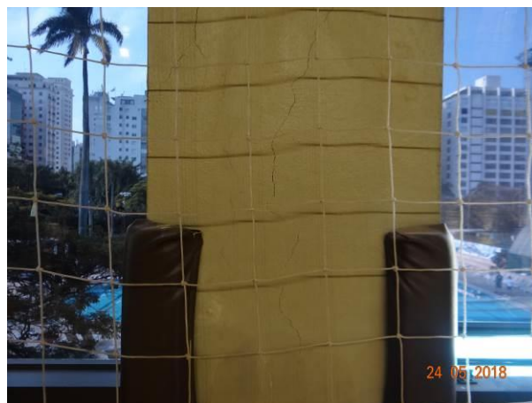
FOTO 24 – Disgregação do concreto indicando a corrosão da armadura embutida na a face Oeste do pilar P79.
