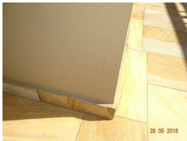
FOTO 14 – Disgregação do concreto na face Sul do pilar P76.
