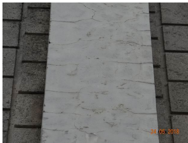
FOTO 28 – Detalhe da anomalia referenciada na foto anterior.
