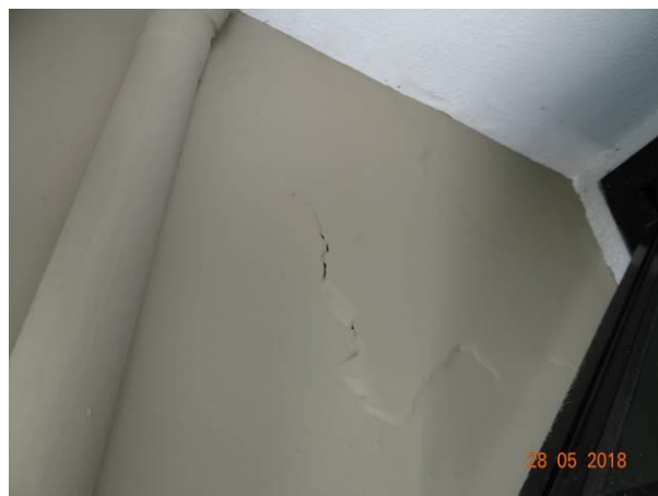
FOTO 12 – Detalhe da anomalia referenciada na foto anterior.
