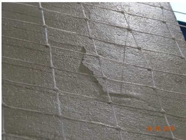
FOTO 15 – Disgregação do concreto indicando a corrosão da armadura embutida na face Oeste do pilar P74.
