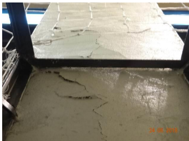
FOTO 25 – Disgregação do concreto indicando a corrosão da armadura embutida na face Oeste do pilar P79.
