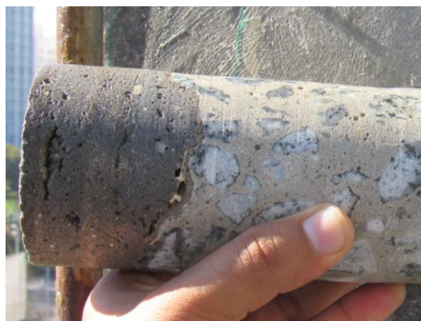
FOTO 48 – Detalhe do testemunho extraído do pilar P10. Notam-se vazios no graute.
