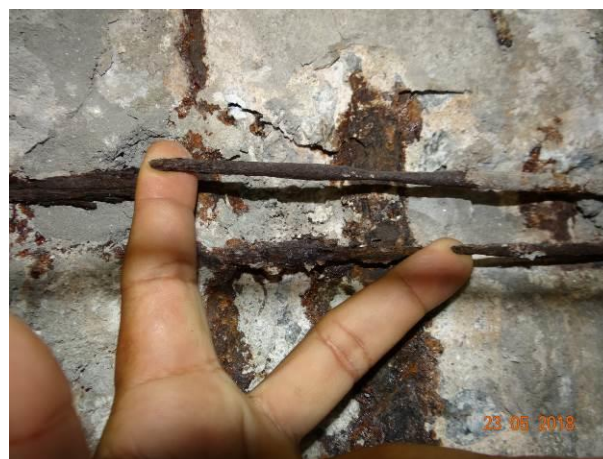
FOTO 58 – Estribo rompido no pilar P74.
