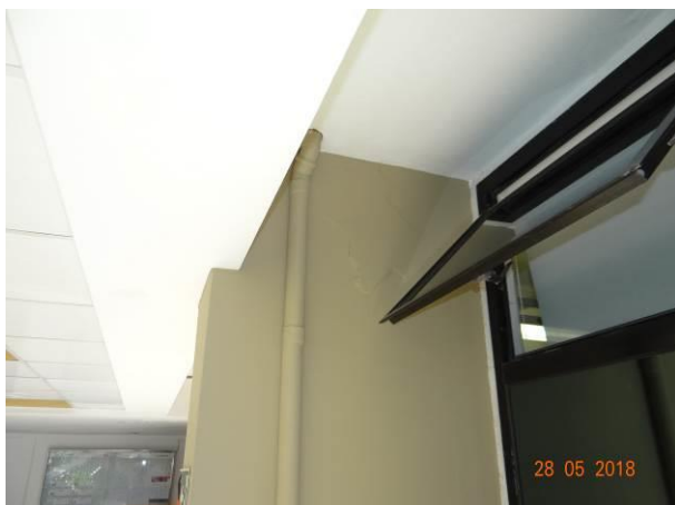
FOTO 11 – Disgregação do concreto em decorrência de corrosão da armadura embutida na face Norte do pilar P74.
