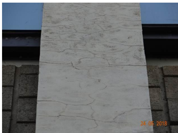
FOTO 31 – Fissuras aleatórias na face Sul do pilar P1.
