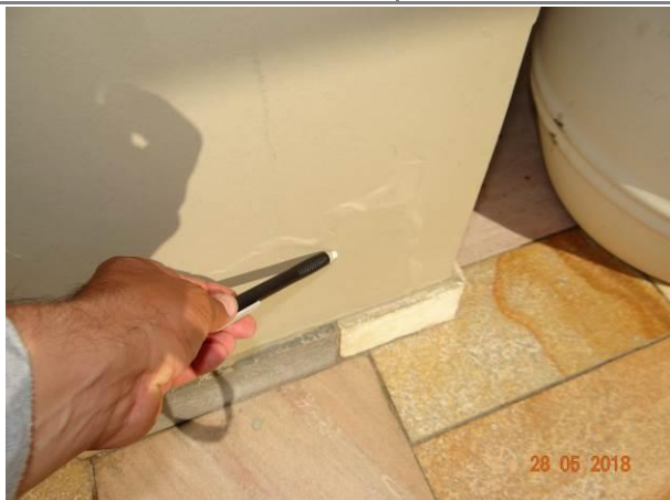
FOTO 9 – Disgregação do concreto em decorrência de corrosão da armadura embutida na face Leste do pilar P74.
