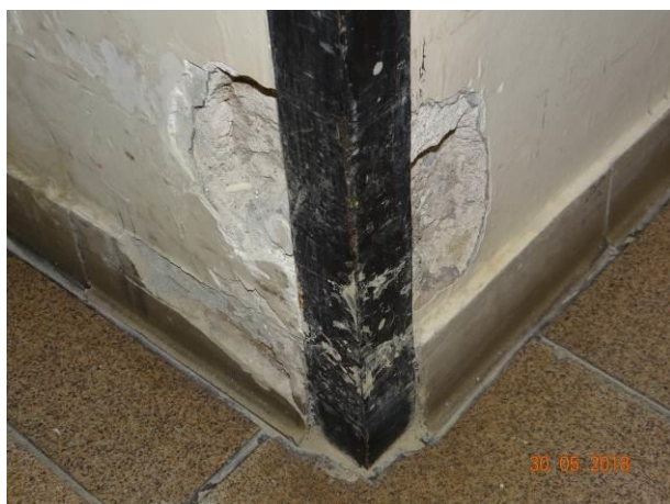
FOTO 5 – Disgregação do concreto no pilar P42.
