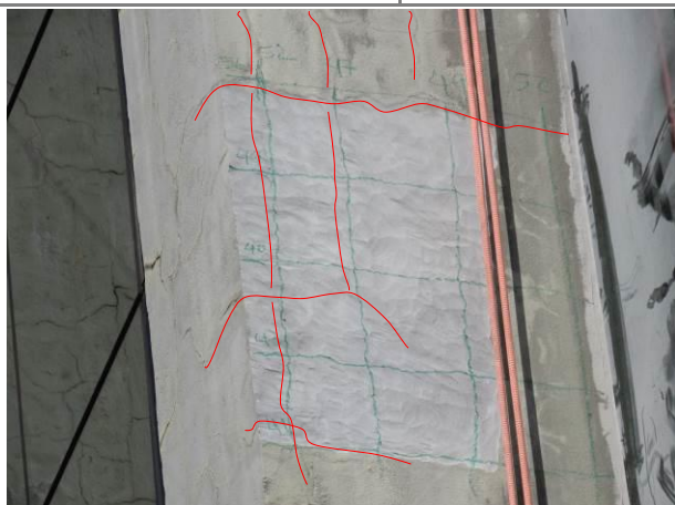
FOTO 45 – Detalhe do pilar P77, onde se observa a posição de algumas fissuras (vermelho), em relação às armaduras embutidas, demarcadas com giz (verde).
