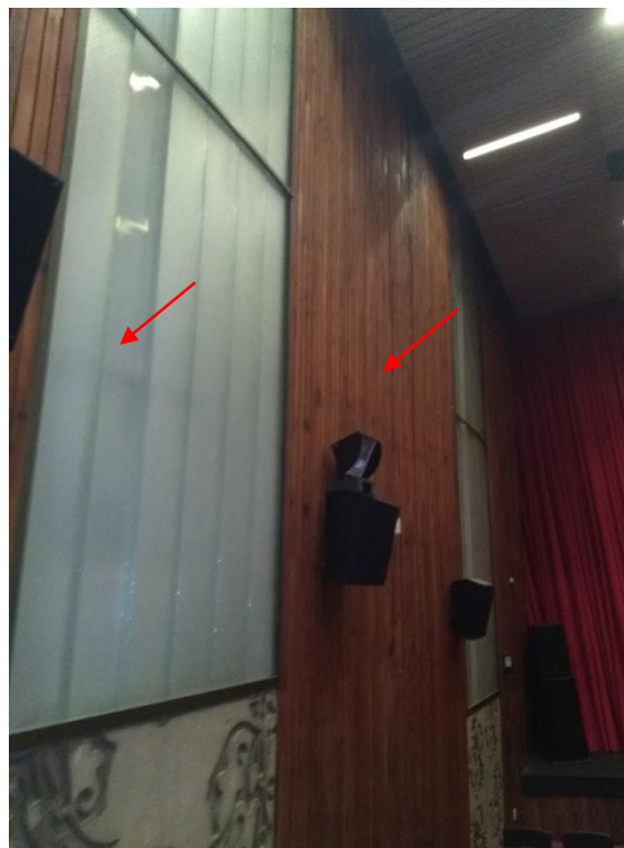
Figura 22. Pilares sem acesso para inspeção no cinema (1º e 2º Andar) – Notar presença de vidro e revestimento sobre os pilares
