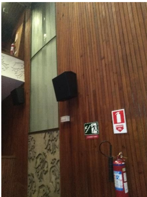
Figura 21. Pilares sem acesso para inspeção no cinema (1º e 2º Andar)
