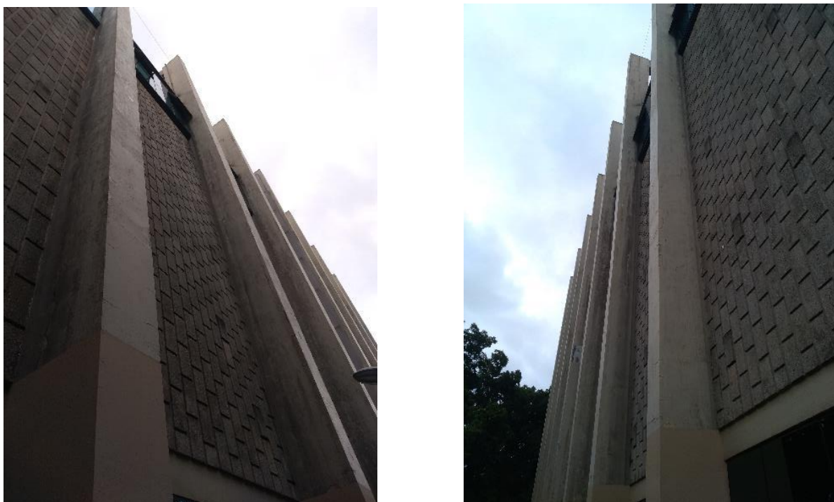
Figura 2. Fachada da Rua Honduras - Notar fissuras nos pilares
