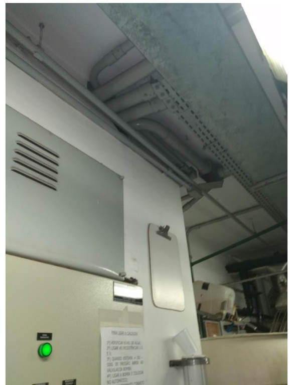
Figura 30. Sala da caldeira (1º subsolo) - Notar a presença de tubulações e instalações ao redor do pilar
