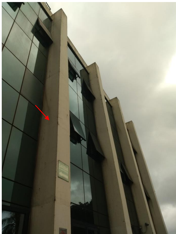
Figura 10. Fachada da Rua Colômbia – Notar fissuras localizadas no 4º andar e pele de vidro no entorno dos pilares
