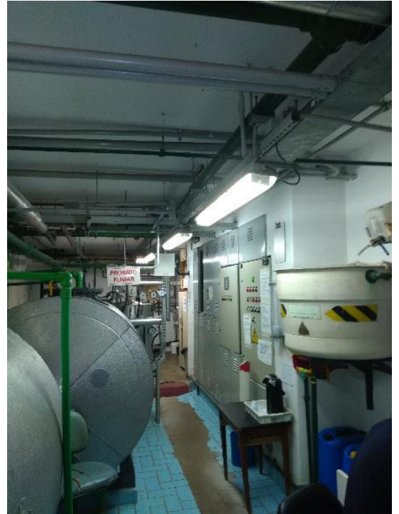
Figura 28. Pilares localizados na sala da caldeira (1º subsolo) - Notar a presença de tubulações no teto
