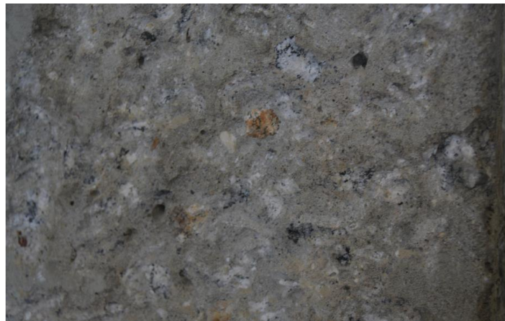
Figura 36 – Detalhe da superfície do concreto com adequada limpeza e exposição dos agregados
