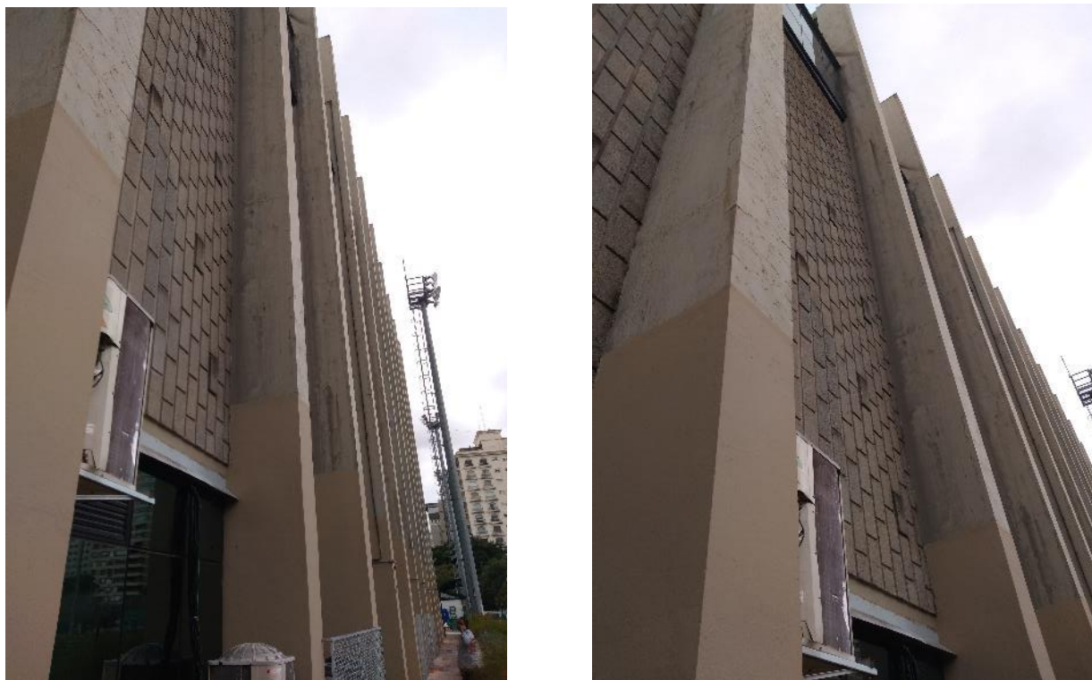
Figura 4. Fachada da Rua Argentina - Notar fissuras nos pilares
