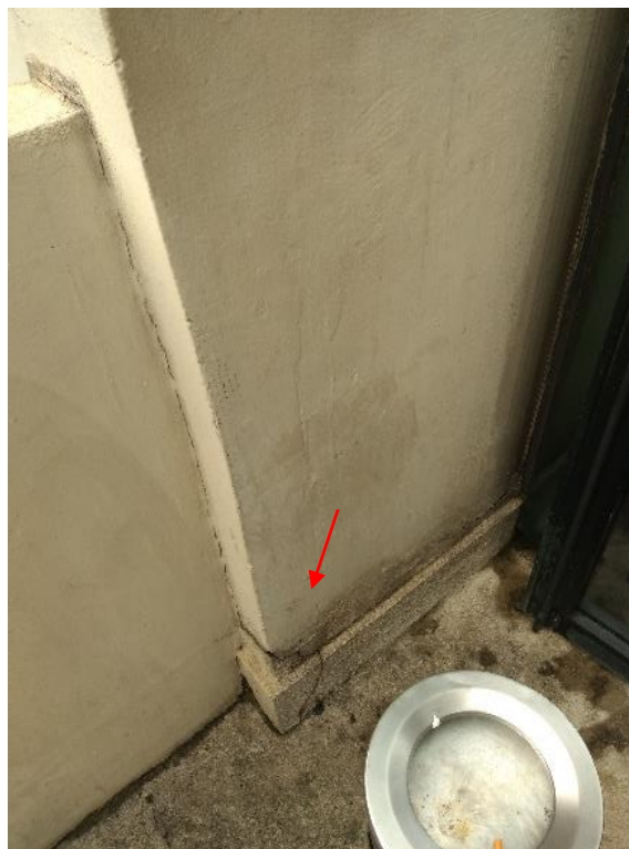
Figura 7. Fachada da Rua Colômbia – Notar fissuras no pé do pilar do 3º andar
