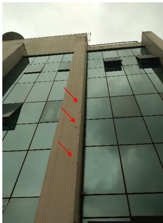
Figura 9. Fachada da Rua Colômbia – Notar fissuras localizadas no 4º andar e pele de vidro no entorno dos pilares
