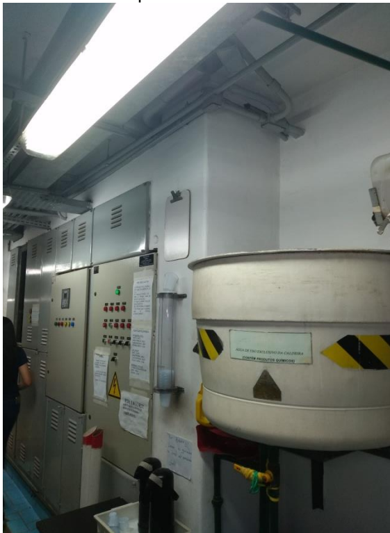
Figura 29. Sala da caldeira (1º subsolo) – Notar a presença de tubulações, instalações e quadros elétricos
