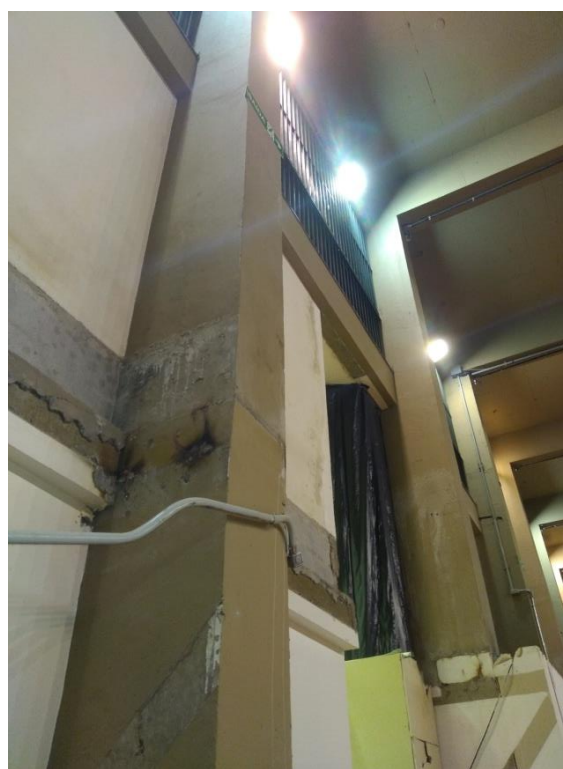
Figura 24. Pilares da quadra (1º e 2º Andar) – Notar a presença de grades, paredes e vigas entre os pilares
