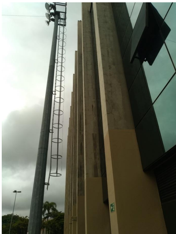
Figura 5. Fachada da Rua Argentina - Notar pintura na parte inferior e pele de vidro no entorno dos pilares
