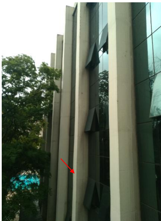
Figura 8. Fachada da Rua Colômbia – Notar fissuras localizadas no 2º andar e pele de vidro no entorno dos pilares
