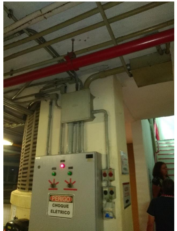
Figura 26. Pilar localizado no 1º Subsolo – Notar a presença de tubulações e quadro elétrico
