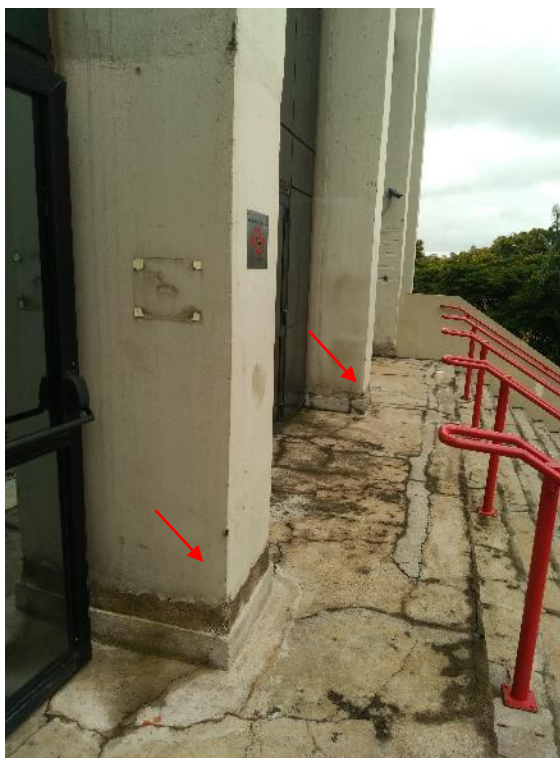
Figura 6. Fachada da Rua Colômbia – Notar fissuras nos pés dos pilares e no piso do 3º andar
