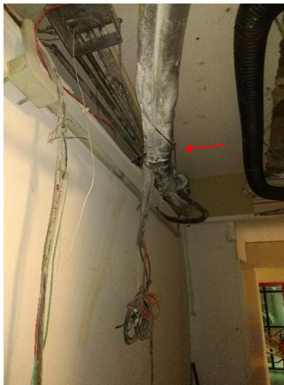
Figura 14. Piso térreo – Notar a presença de tubulações e fios ao redor do pilar
