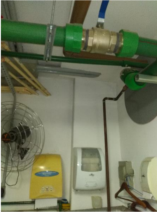
Figura 27. Sala da caldeira (1º subsolo) – Notar a presença de tubulações e instalações ao redor do pilar
