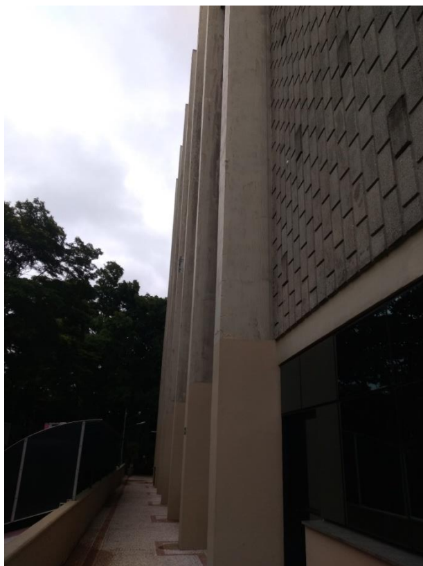
Figura 3. Fachada da Rua Honduras - Notar pintura na parte inferior dos pilares
