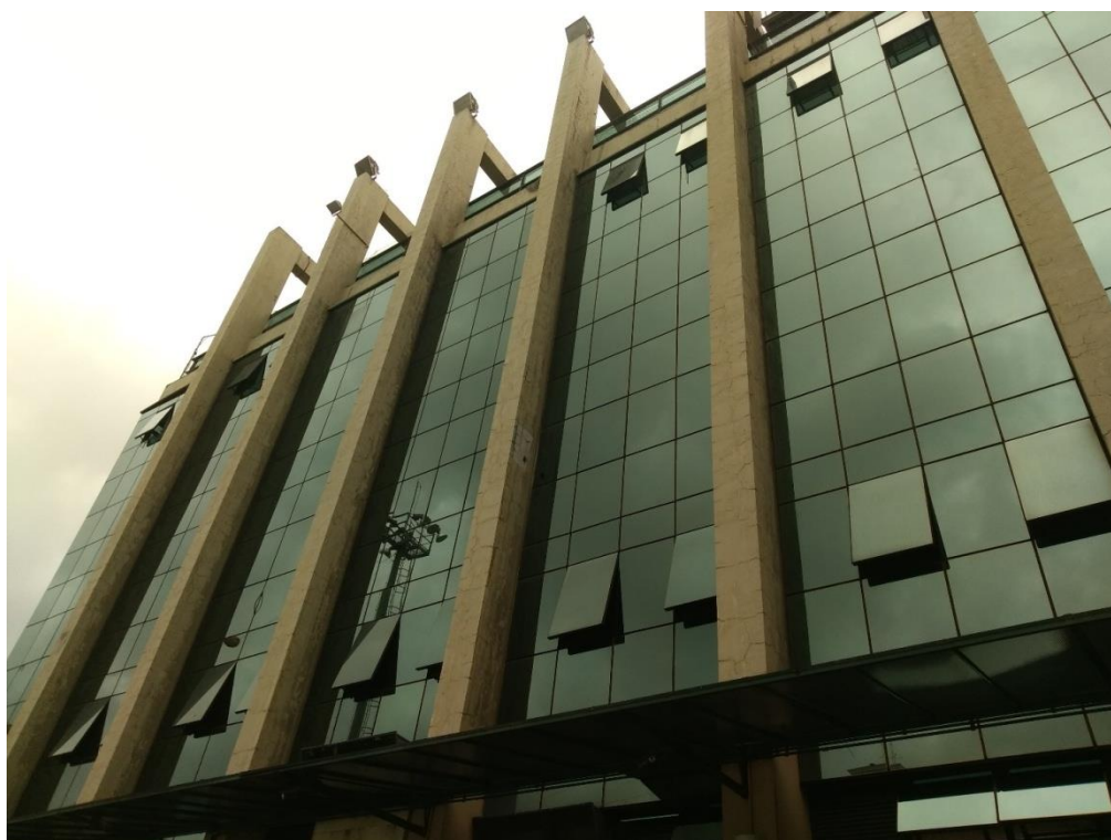
Figura 11. Fachada da Rua Estados Unidos – Notar fissuras em todos os pilares
